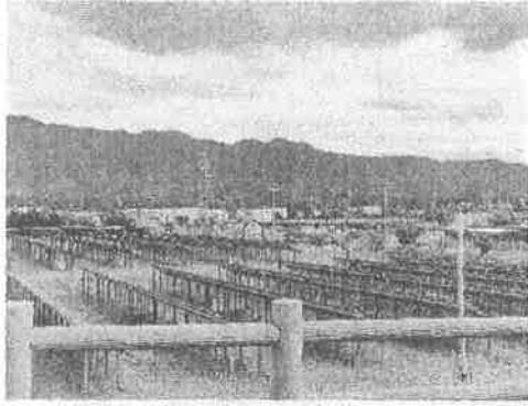
写真③ メガソーラー発電設備
